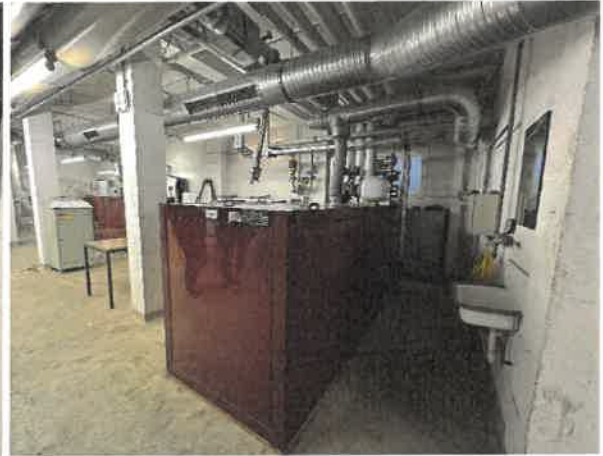
Blockheizkraftwerk in der Graf-Eberhard Gemeinschaftsschule
